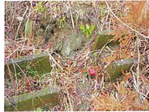
写真⑤：3月初旬 初生ブロック頭部付近 側溝の損壊 現時点で明瞭な進行なし
