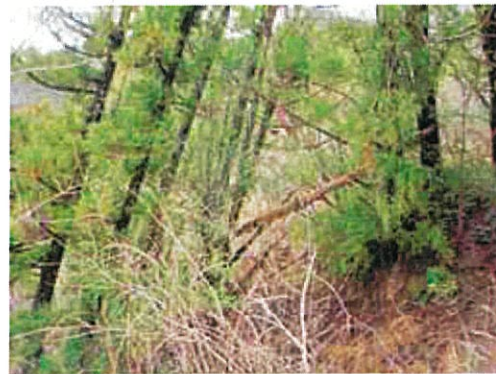
写真④：3月初旬 初生ブロック頭部付近 樹木の倒壊 現時点で明瞭な進行なし
