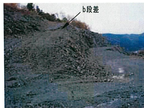
写真①：3月初旬 2次すべり頭部付近 b段差は軽微
